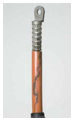
Образец, поврежденный трекинговой дорожкой
